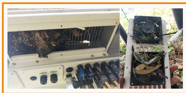
Figuur 1: De opeenhoping van gevallen bladeren blokkeert de koelluchtkanalen en ventilatoren
