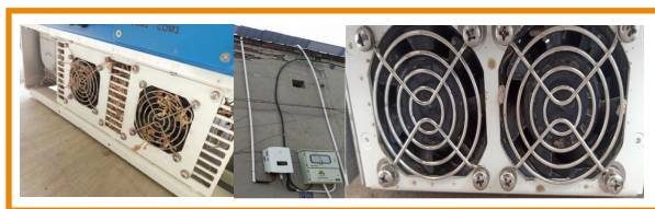
Figuur 3: Vuil blokkeert de omvormerluchtkanalen en -ventilatoren, waardoor de omvormer defect raakt
