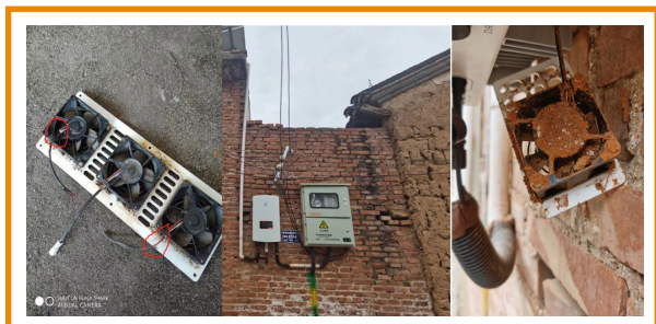
Figuur 2: Knaagdier bijt in de ventilatorkabel en het zand zit vast aan de ventilator
