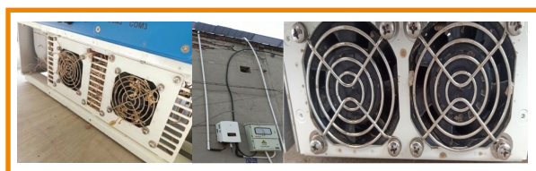
Figura 3: Gruz blokuje kanały powietrzne i wentylatory falownika, powodując awarię falownika
