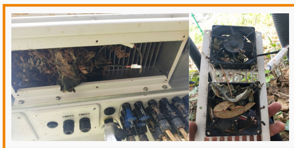
Figura 1: Nagromadzenie opadłych liści blokuje kanały powietrza chłodzącego i wentylatory.
