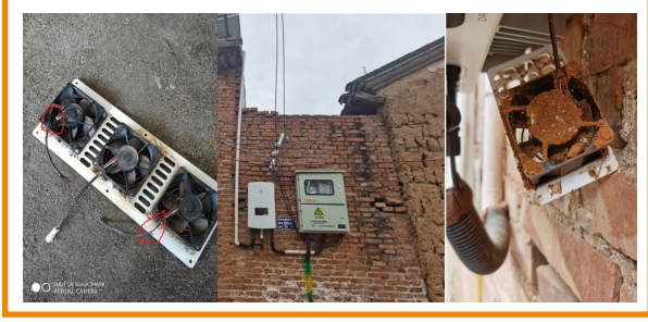
Şekil 2: Kemirgen hayvanlar fan kablosunu ısırarak hasar vermiştir, kum taneleri de fan üzerinde yapışık kalmaktadır
