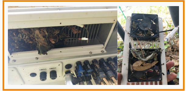
Şekil 1: Düşen yaprakların birikmesi neticesinde soğutma havası kanalları ile fanlar tıkanır
