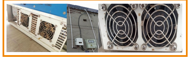
Şekil 3: Kalıntılar invertör arızasına neden olacak şekilde inverter hava kanallarını ve fanları tıkmaktadır
