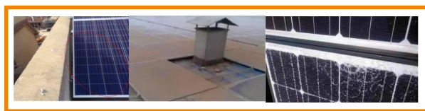
Hình 4: Tấm PV bị tắc và hư hỏng
